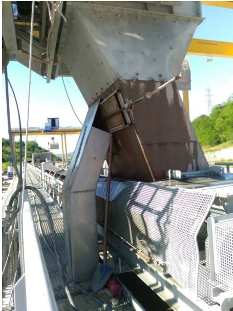
Figura 9 - Tramoggia con campionatore a deviazione di flusso
